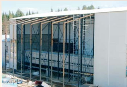
Gewebebandtrockner in der Aufbauphase
