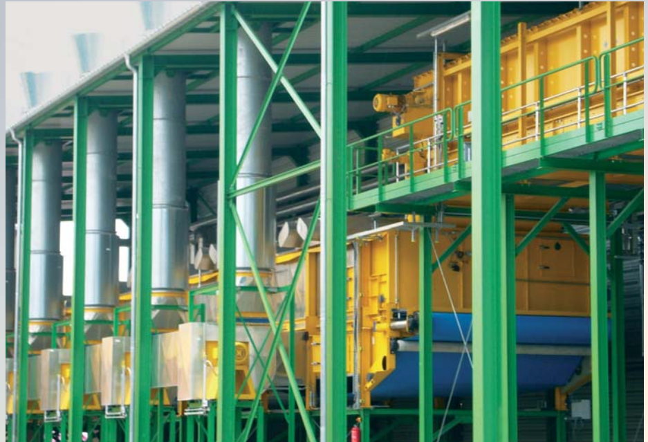
Gewebebandtrockner in einer Holzpelletieranlage
